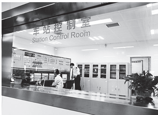
图 2-8 城市轨道交通车站的控制室
