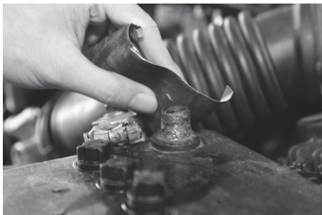
图1-15 检查极桩和电缆夹
