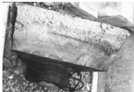
图 2-2-16 疲劳断裂失效
