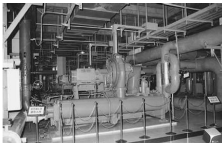
图 1-1-3 中央空调冷水机房
